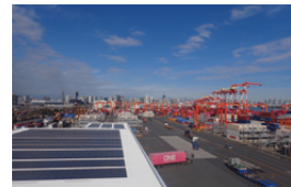
東京国際コンテナターミナルにおける太陽光発電システム
