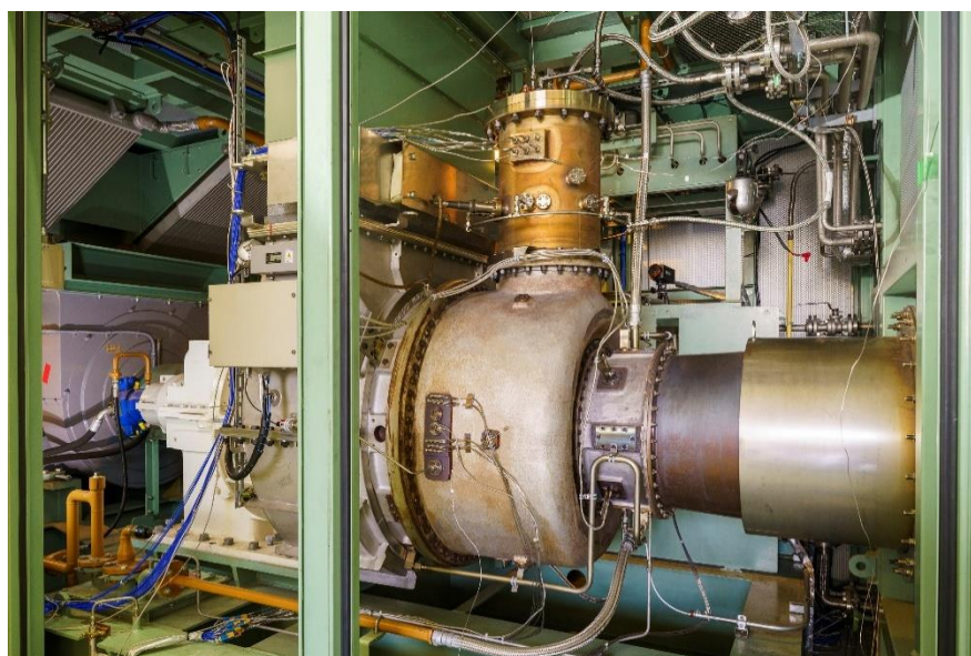
IHI製2,000kW級ガスタービン
