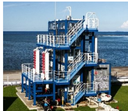
OTEC実証設備(久米島)
